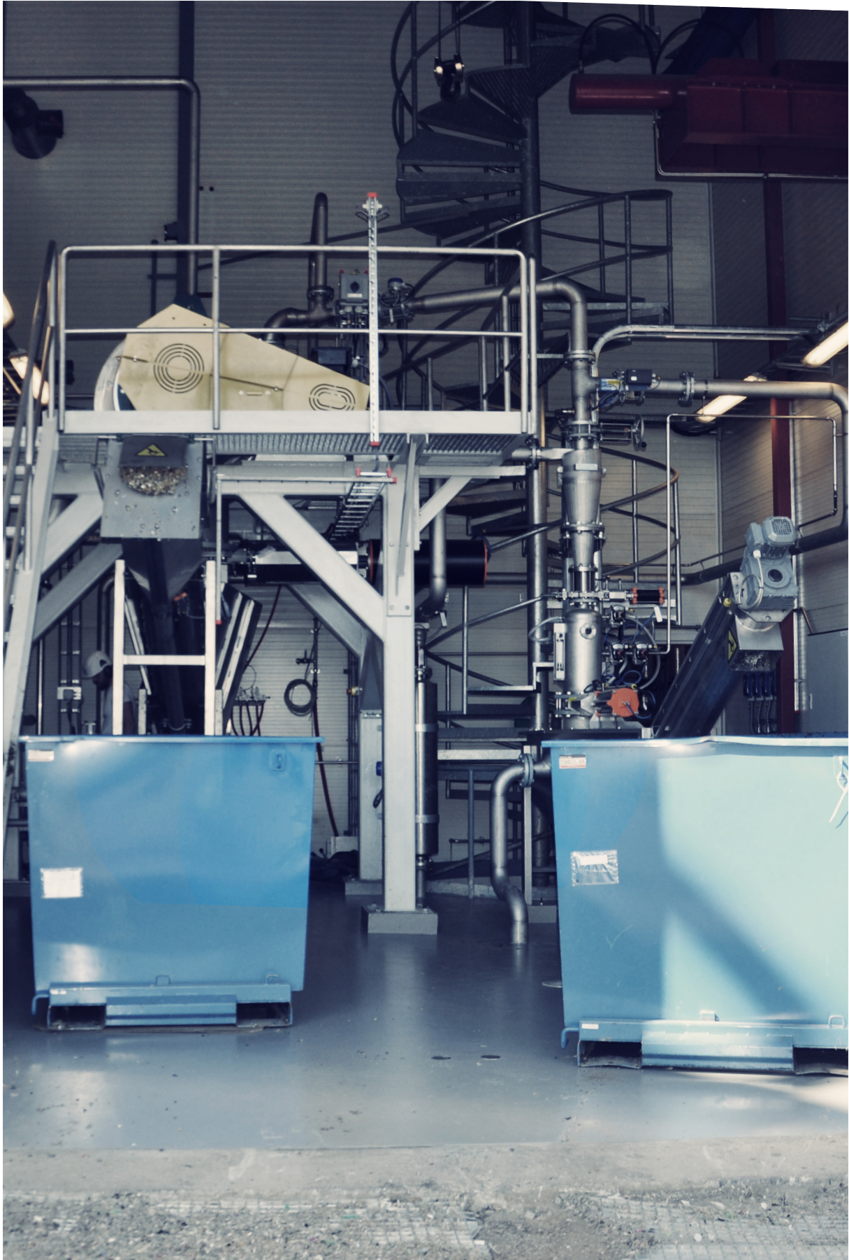
Utrustningen från Cellwood Machinery har en egen hall på Frevar KF Biogas Anlegg i Gamle Fredrikstad. Här är det rent och snyggt och i princip ingen lukt. Till höger på bilden separeras tyngre partiklar som glas, grus och metall. Till vänster separeras plast.
